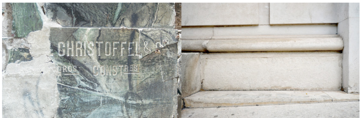
Figura 13 Epígrafe arquitetônicas danificadas em São Paulo (foto de Haroldo Gallo), e em Londres (foto de Priscila Farias).
